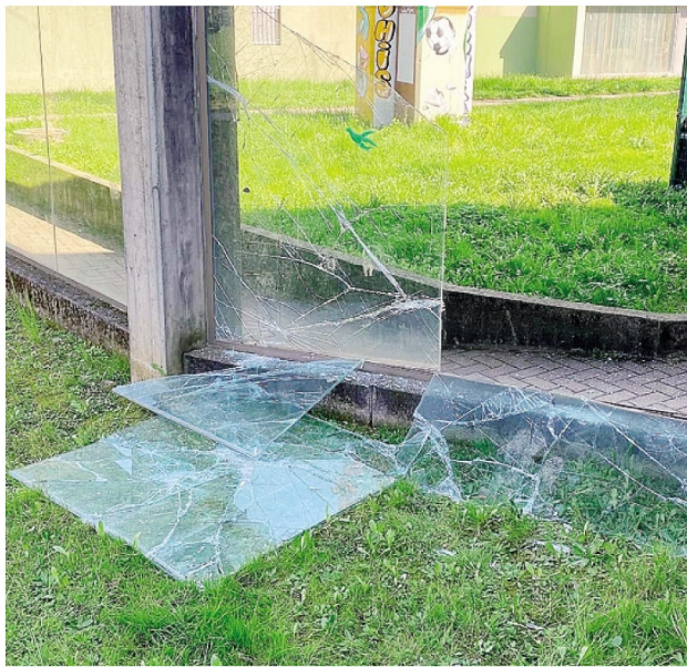
Le vetrate del passaggio pedonale della scuola media distrutte dai vandali
