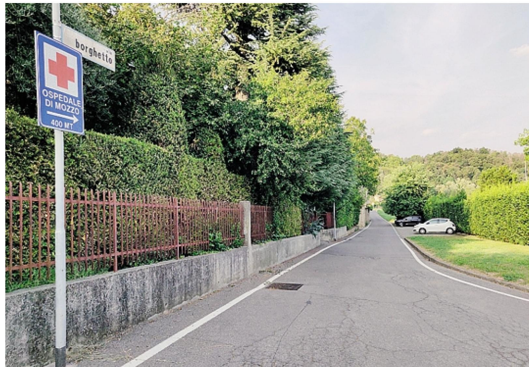
L'inizio di via Borghetto. Il manto stradale è dissestato per le piogge dei mesi scorsi FOTO YURI COLLEONI
